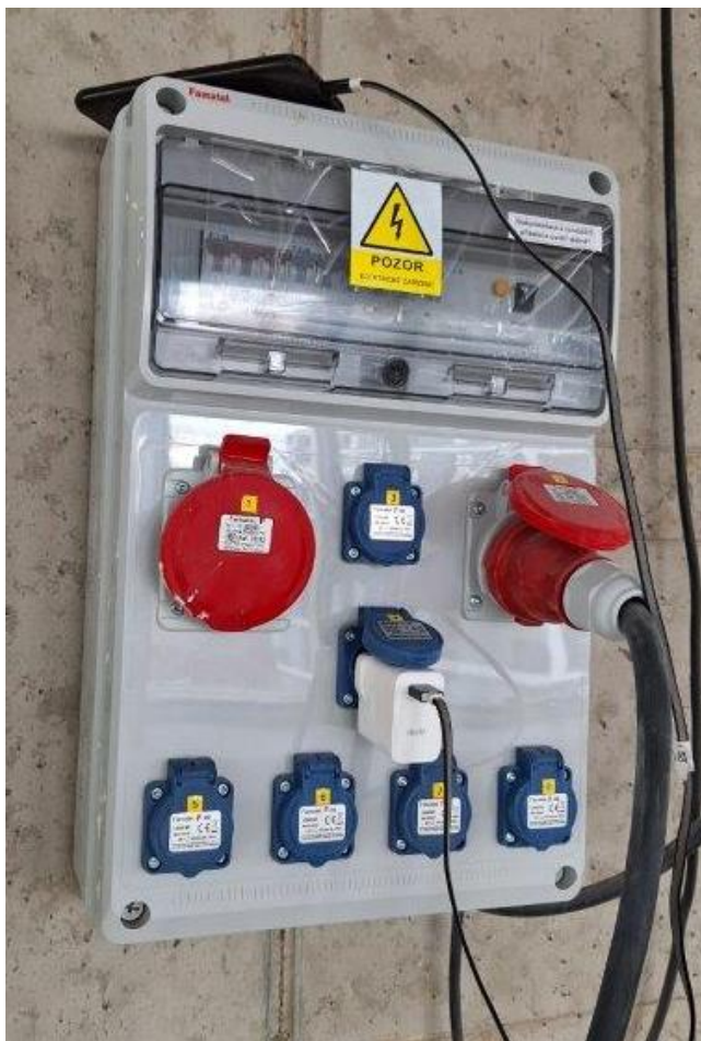
Kvalitní staveništní rozvaděče na jednotlivých patrech
